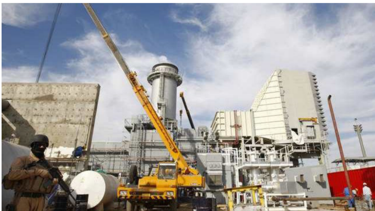
إحدى محطات توليد الطاقة الكهربائية
