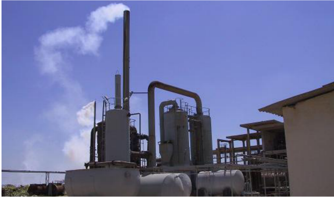
إحدى المحطات الكهربائية
