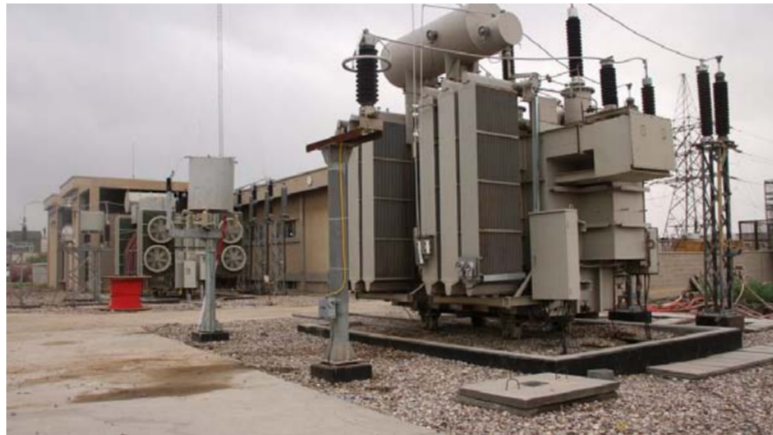
محطة كهرباء شمالي الناصرية
