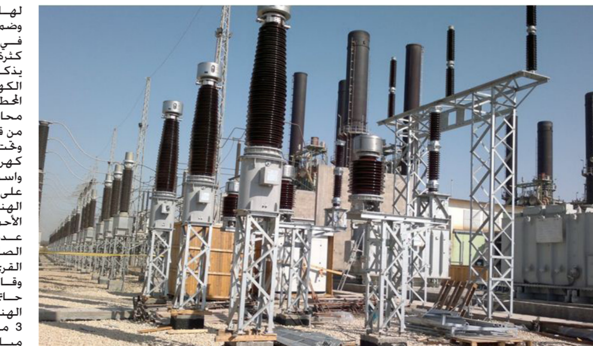
احدى المحطات الكهربائية في البلاد
