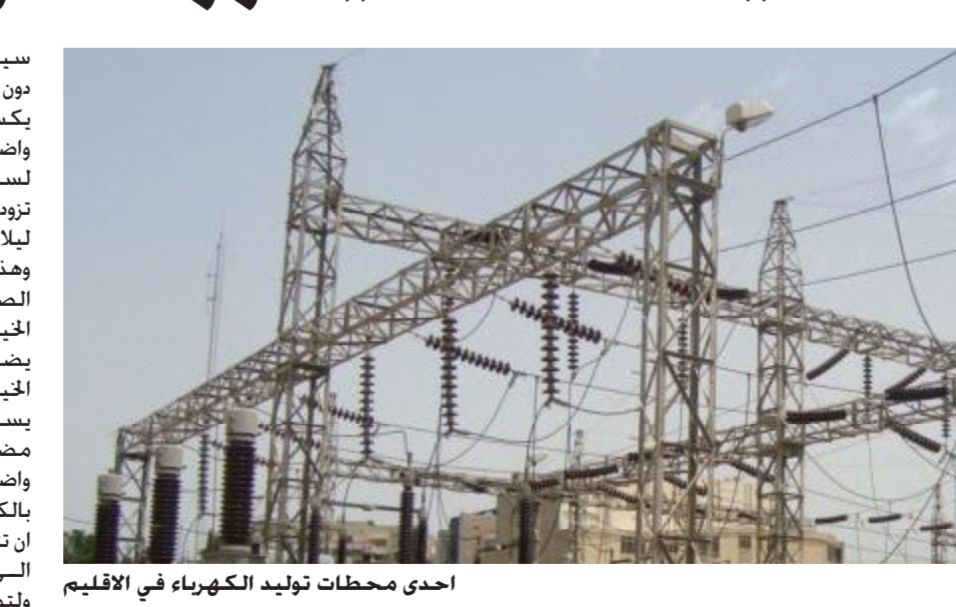
احدى محطات توليد الكهرباء في الاقليم
